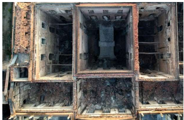
Teil des Gebäudes nach dem Brand Foto: AFP, M. Pimentel
